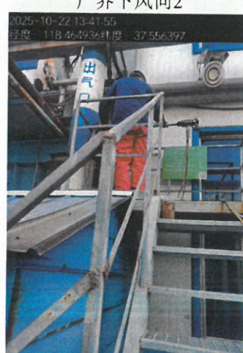
DA005 5000 吨 MBS 车间工 艺废气净化装置 1#排气筒
