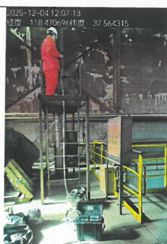
DA010 二胺北厂区工艺废 气净化装置 2#排气筒
